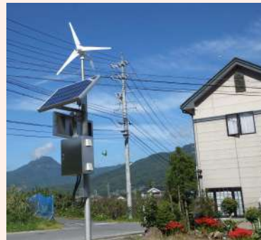
制御盤の内蔵部品 ディープサイクルバッテリー（115A） 充電コントローラー/電圧計*2 電流計*2 が内蔵されています （充電・放電独立表示）
