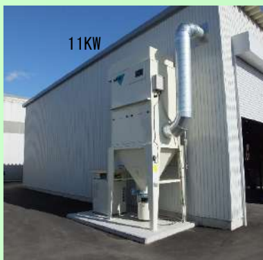
【大型集塵機設備】
